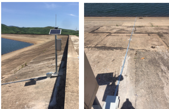
Hình 8. Trạm đo mực nước hồ kết hợp đo mưa được lắp đặt tại hồ chứa nước Thượng Sông Trí - tỉnh Hà Tĩnh
